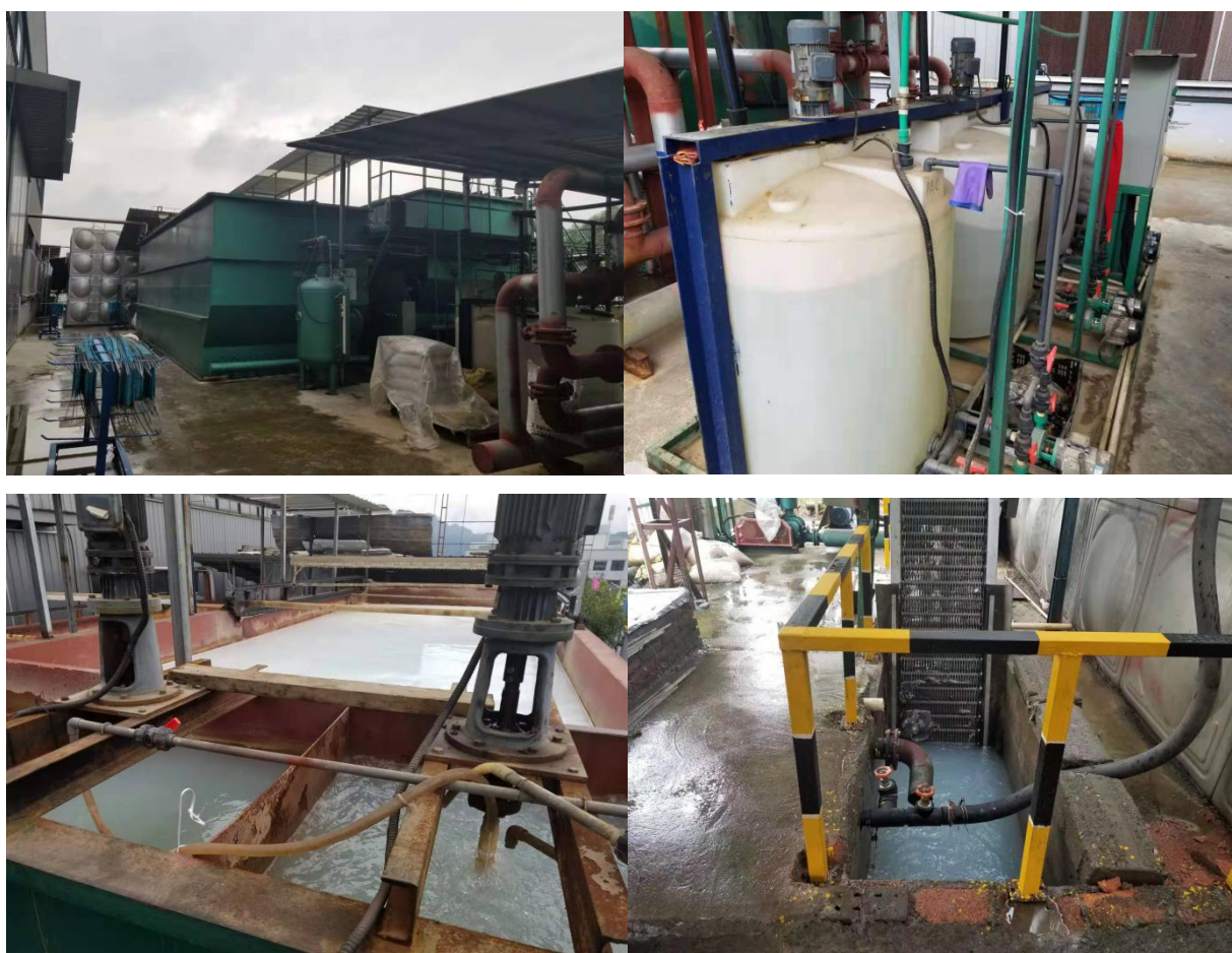
图 4-3 污水处理站现场图
