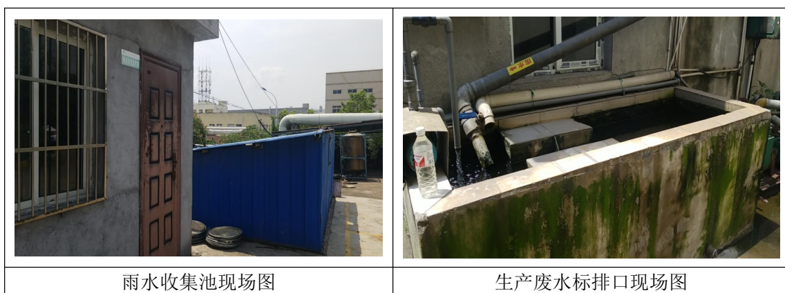
图 5-1 企业废水产污及处理设施现场图
