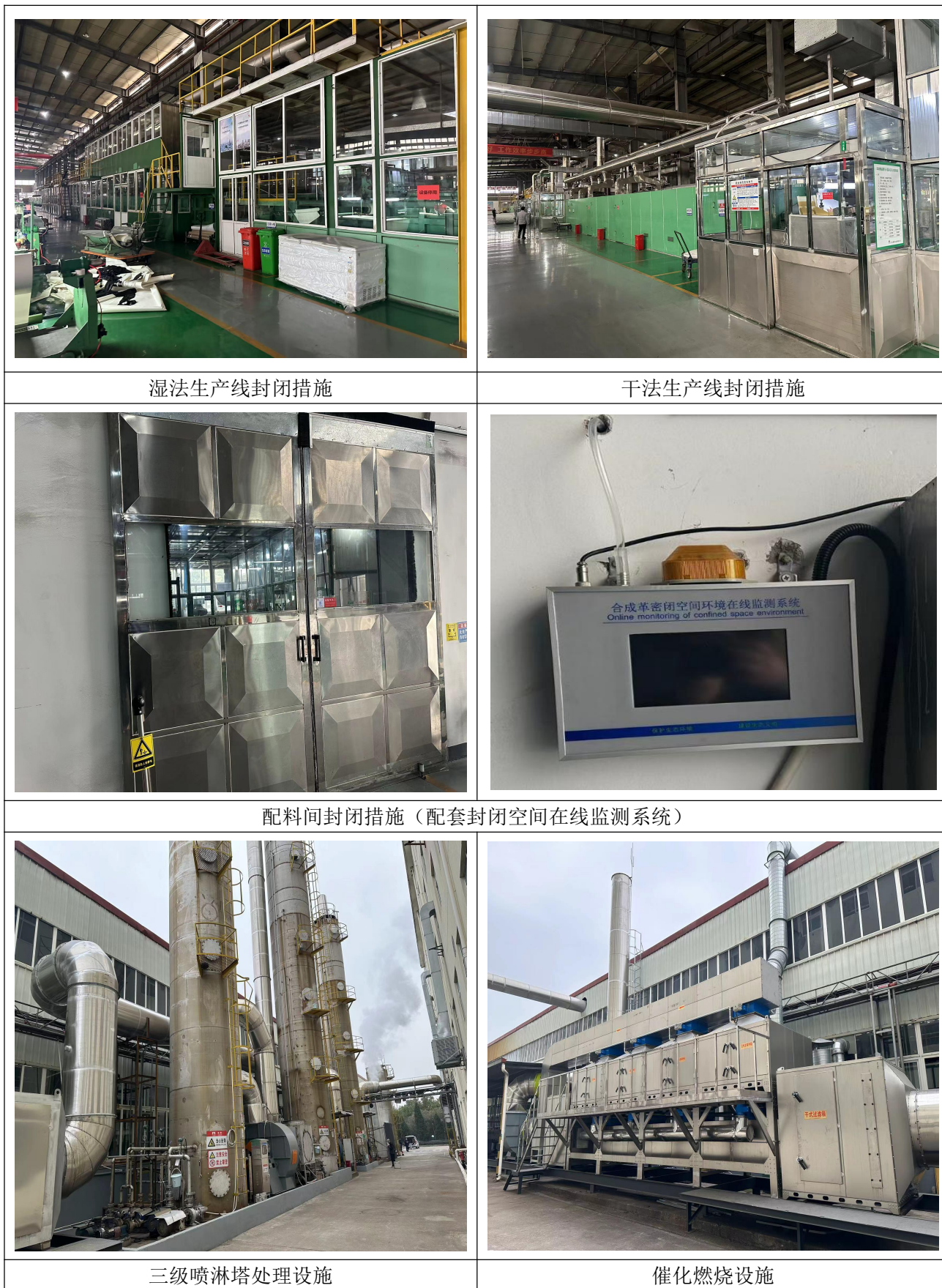
图 5-4 现场废气收集防治措施
