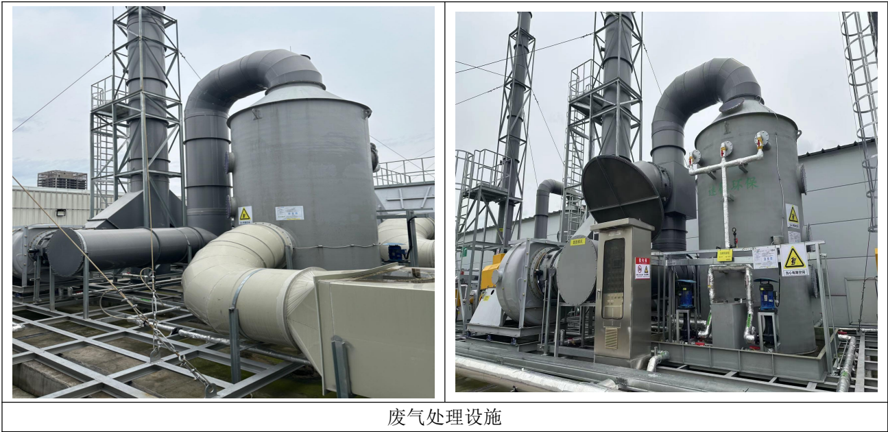
图 5-7 项目废气处理设施建设情况
