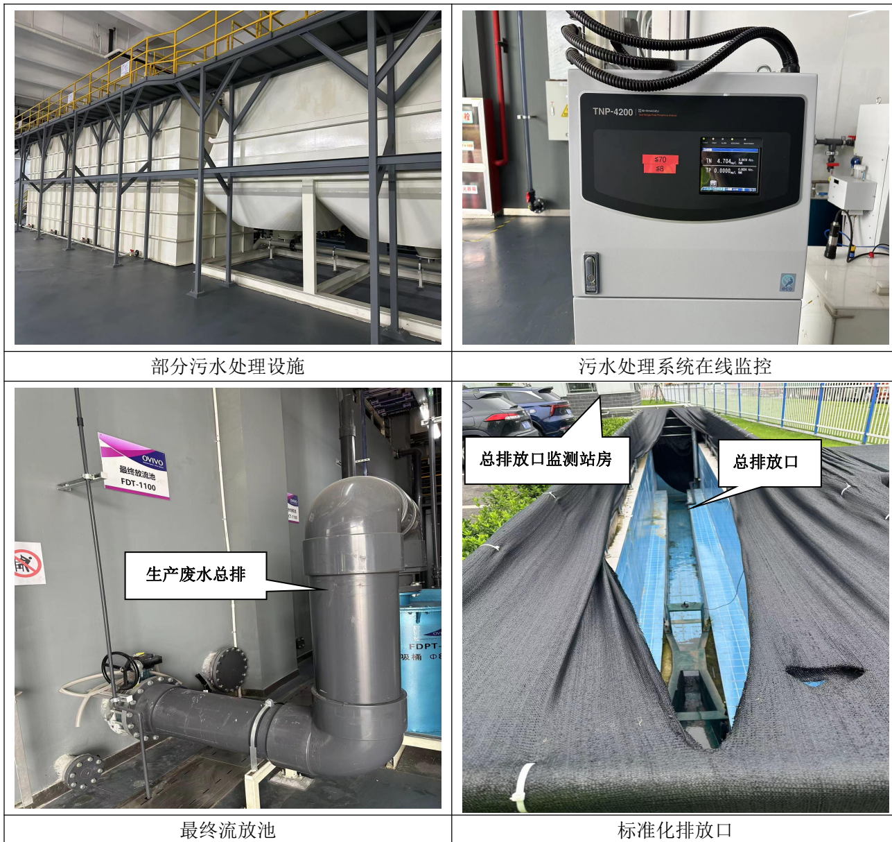
图 5-6 项目废水处理设施建设情况
